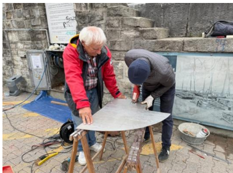
Mise en place du 1er nouveau Karcher aux Pâquis
